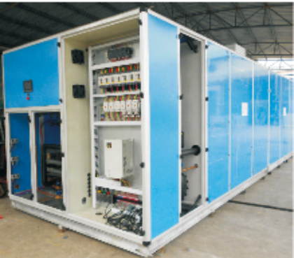
机组电控部分 Electrical Control Inside
